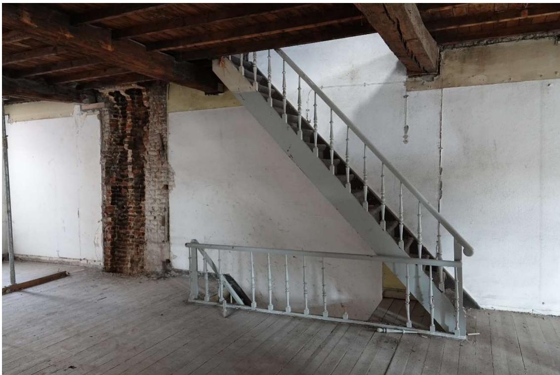
Foto 14. Huidige trap 3 e verdieping naar zolder, tevens zijn de restanten van een recent gesloopte schoorsteen/rookgaskanaal zichtbaar.
