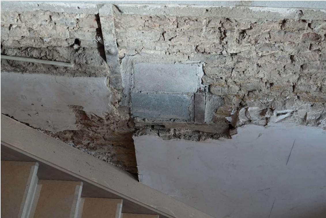
Foto 1. Dichtgezette oplegging van de recent ingekorte moerbalk van de 1 e verdiepingsvloer.
