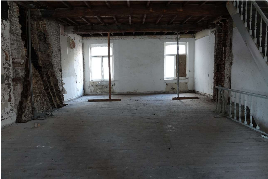
Foto 13. Binnenzijde achtergevel 3 e verdieping, links en rechts op de foto de restanten van de recent verwijderde schoorstenen/rookgaskanalen. Tevens is de muurbalk v.z.v. kunsthars zichtbaar op deze foto.
