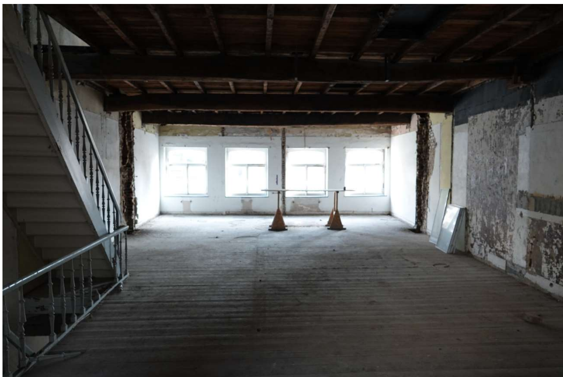
Foto 12. Binnenzijde voorgevel 3 e verdieping, links en rechts op foto de restanten van de recent verwijderde schoorstenen/rookgaskanalen.
