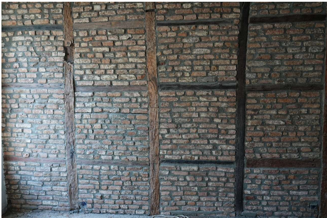
Foto 9. Houten vakwerkwand, 2 e verdieping.
